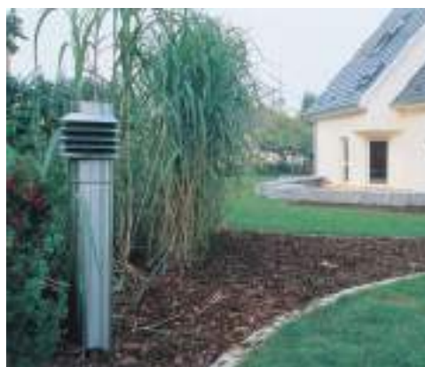
Bouche d'extraction d'un échangeur air-sol (puits canadien) permettant de rafraîchir de 5°C à 8°C l'habitat.
